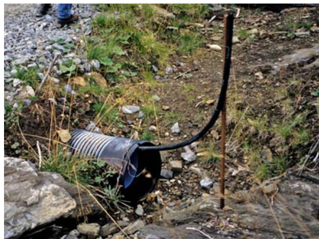
Figur 21. Stikkrenne med tineslange. Foto: Truls-Erik Johnsrud.
