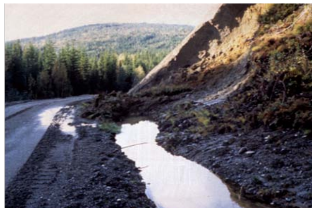
Figur 32. Masseutglidning ut i grøft og vegbane. Foto: Nils Olaf Kyllø.
