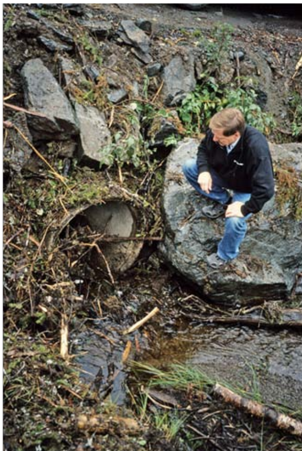
Figur 33. Kvist fra hogst har tettet stikkrenna. Foto: Truls-Erik Johnsrud.
