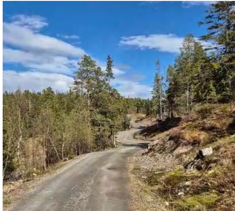
Når en vei ikke bygges etter kravene. Foto: Håkon Holmli
