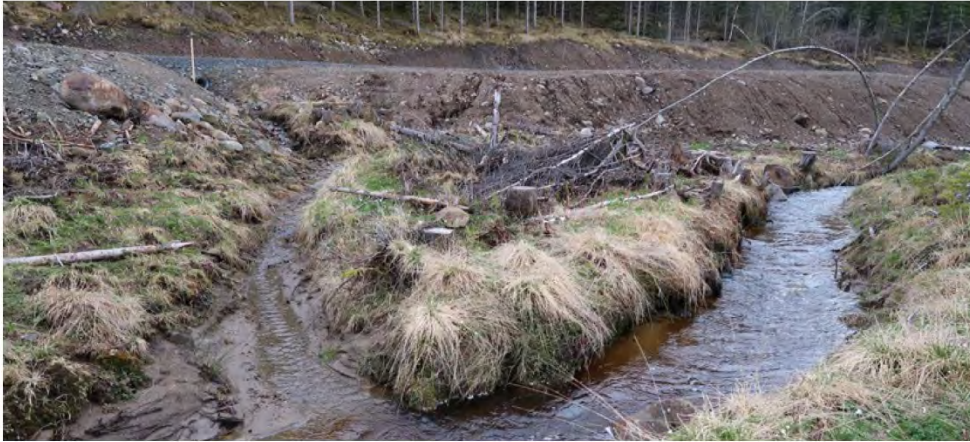
Dårlig utførelse gir partikkelavrenning til bekk. Foto: Helge B. Pedersen
